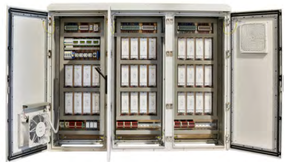
Converterkästen und -schränke für größere Anlagen
